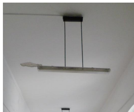
Figura 4.18 - Particolare dei corpi illuminanti ubicati nei corridoi
