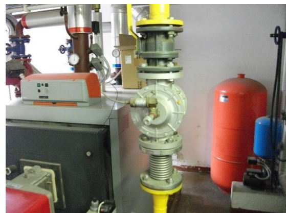
Figura 8.6 – Particolare del generatore di calore attualmente installato
