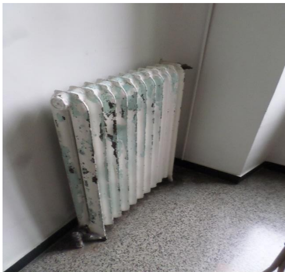
Figura 4.8 – Particolare dei radiatori in ghisa
