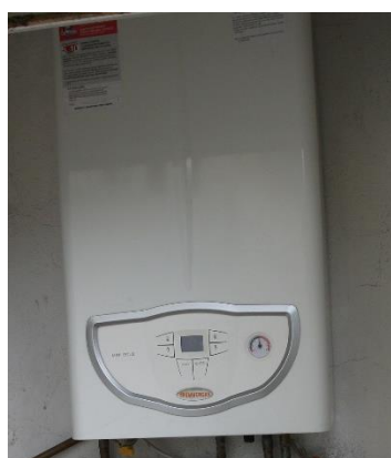
Figura 4.16 - Particolare della caldaia murale per la produzione di acqua calda sanitaria Piano Terra
