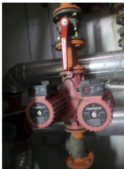
Figura 8.9– Particolare delle pompe di circolazione
