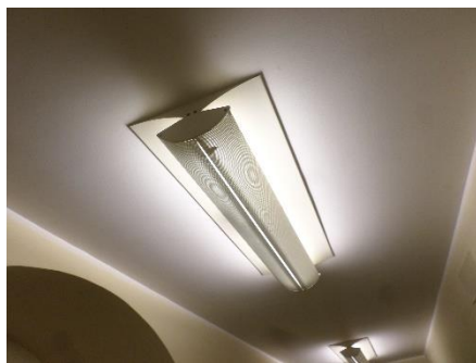
Figura 4.19 - Particolare dei corpi illuminanti installati a soffitto
